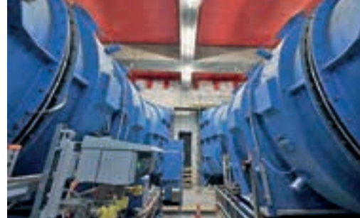
Die Luftmenge, die die Ventilatoren fördern, wird über eine Drehzahlregelung, die mit Hilfe von Frequenzumrichtern realisiert wird, und über die Laufschaufelregelung angepasst. Dabei wird mit Hilfe einer Hydraulik durch unterschiedliche Öldruckvorgaben der Anstellwinkel aller Laufschaufeln synchron im Betrieb verstellt. Quelle: AlpTransit Gotthard AG
