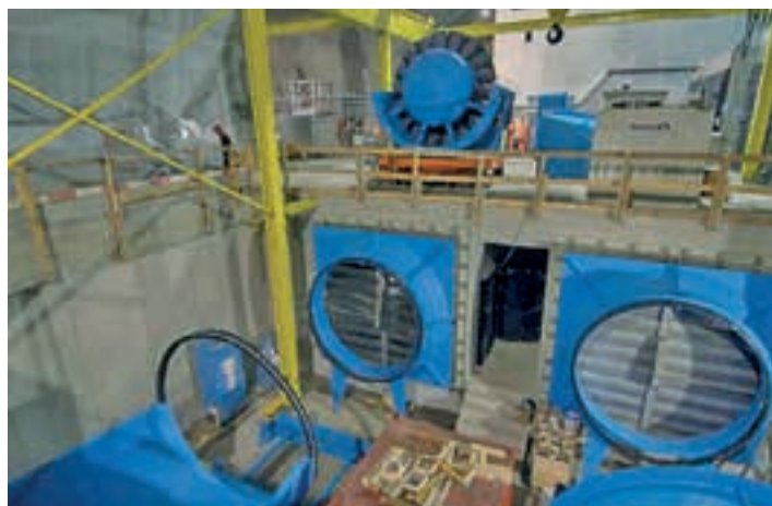
Für frische Luft im Gotthard-Basistunnel sorgen Großventilatoren der TLT-Turbo GmbH, die eigens für diesen Einsatz entwickelt wurden. Sie werden im normalen Betrieb ebenso benötigt wie bei Wartungs-, Service- und Reparaturarbeiten im Tunnel, aber auch für die Rauchabsaugung im Brandfall und eine separate Belüftung der Fluchtwege. (oben)
